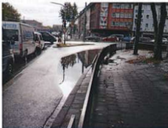
Entwässerungsprobleme Fahrbahn und Gehweg
