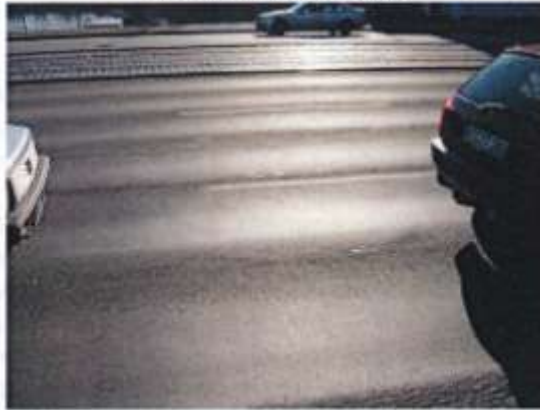
Spurrillen An der Fuldabrücke
