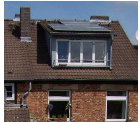
Kleinanlage auf Dachgaube 2004 Planungsgruppe Bau+Energie
