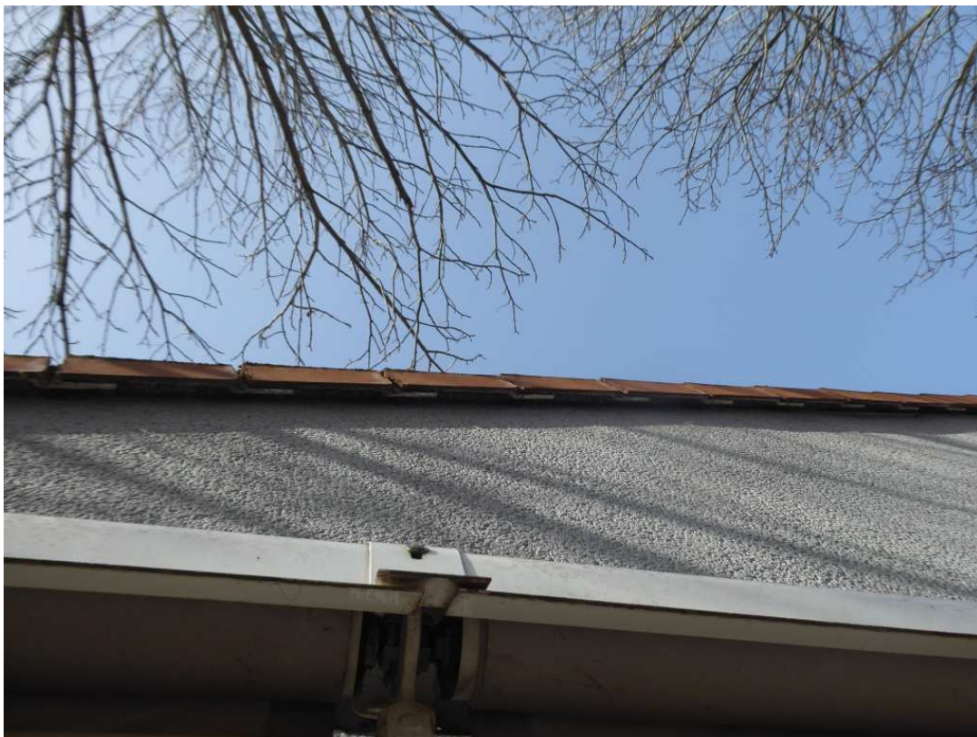
Bild 16: Spalte an Dachanschluss an neuem Gebäude an der Görlitzer Straße
