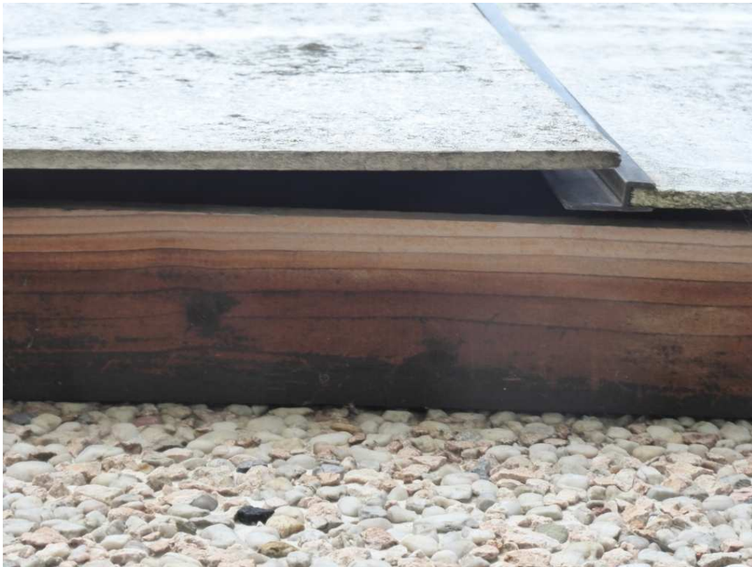
Bild 15: Spalte an Dachanschluss, Detail
