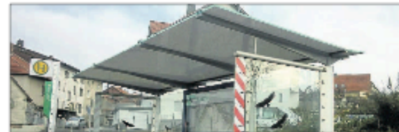
Das Dach der Bushaltestelle Bahnstation Niederhone wurde mit nicht durchsichtiger Sonnenschutzfolie ausgerüstet.
