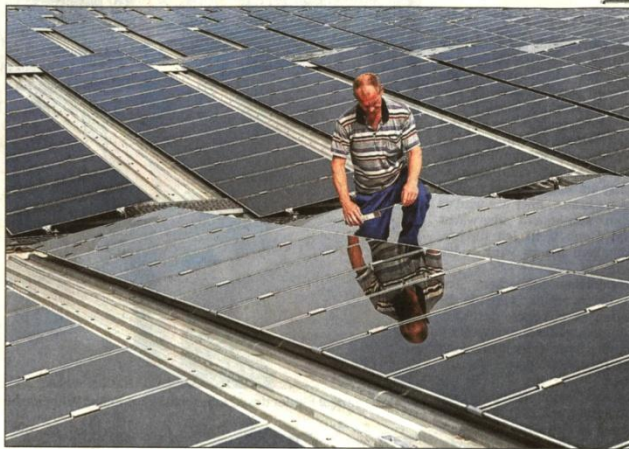
Kraftwerk auf dem Dach: Als ein Beitrag zum Klimaschutz sollen künftig mehr Solardächer an Kasseler Dächern installiert werden. Architekt: dpa
