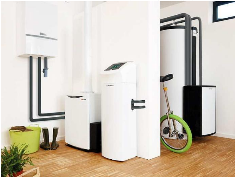
Abbildung 105: Das Mikro-BHKW als platzsparendes Kraftwerk (Quelle: Freie Presse).
