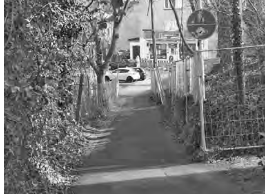
Schlecht ausgebauter Fuß- und Radweg in der Budengasse
