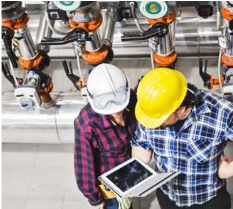
Wärme- und Heizungsanlagen
