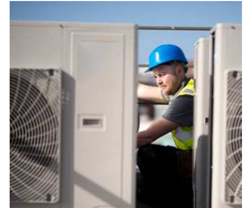
Kälte- und Klimaanlage
