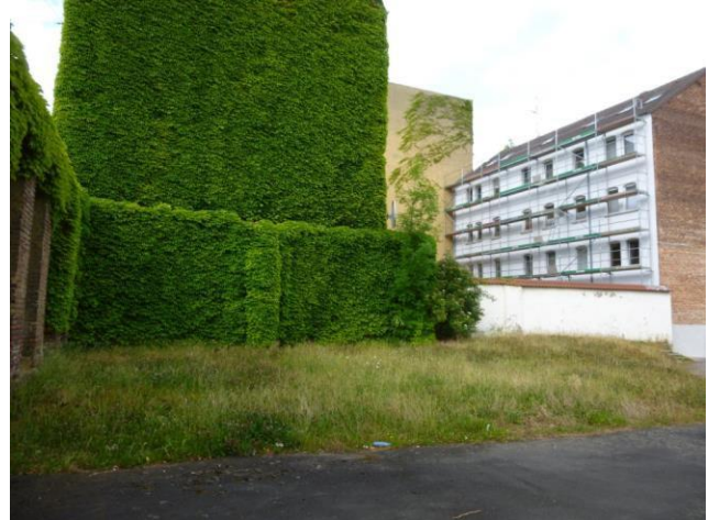
Vollständig von wildem Wein bewachsene Wand im Bereich der Baulücke zwischen Frankfurter Straße 159 und 163
