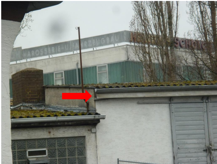
Abbildung 12: Teilaufnahme des Dachbereichs der Nebengebäude. Der Pfeil zeigt auf abgeplatze/aufgebrochene Bauteile. Hinter solchen Öffnungen können sowohl Vögel als Fledermäuse Quartiere finden.
