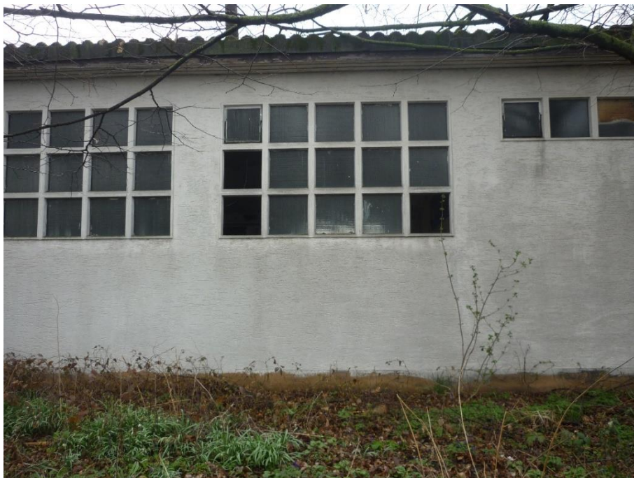
Abbildung 13: Ausschnitt der Garagenrückseite Blick aus Richtung der Nebenstraße Sandershäuser Straße. Die Fenster sind teilweise noch geöffnet oder aber defekt/zerschlagen.
