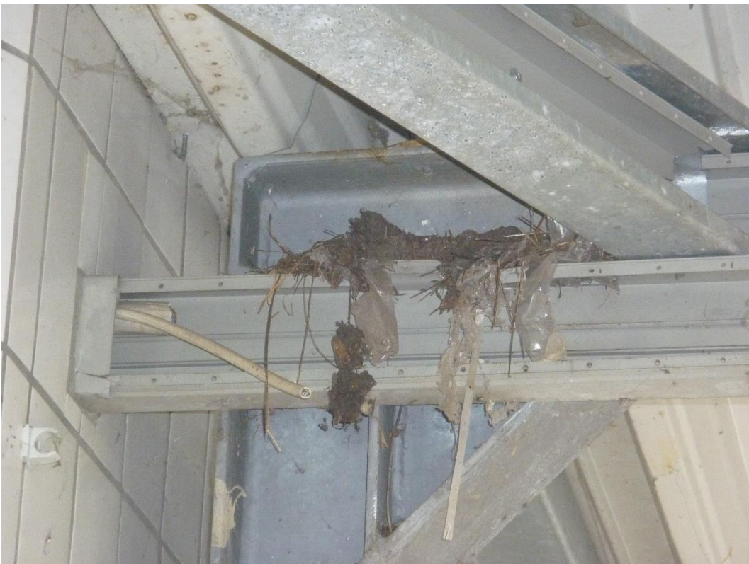
Abbildung 19: Zerstörtes/zerfallenes Altnest. Das Nest befindet sich ebenfalls auf einem Träger der Dachkonstruktion.
