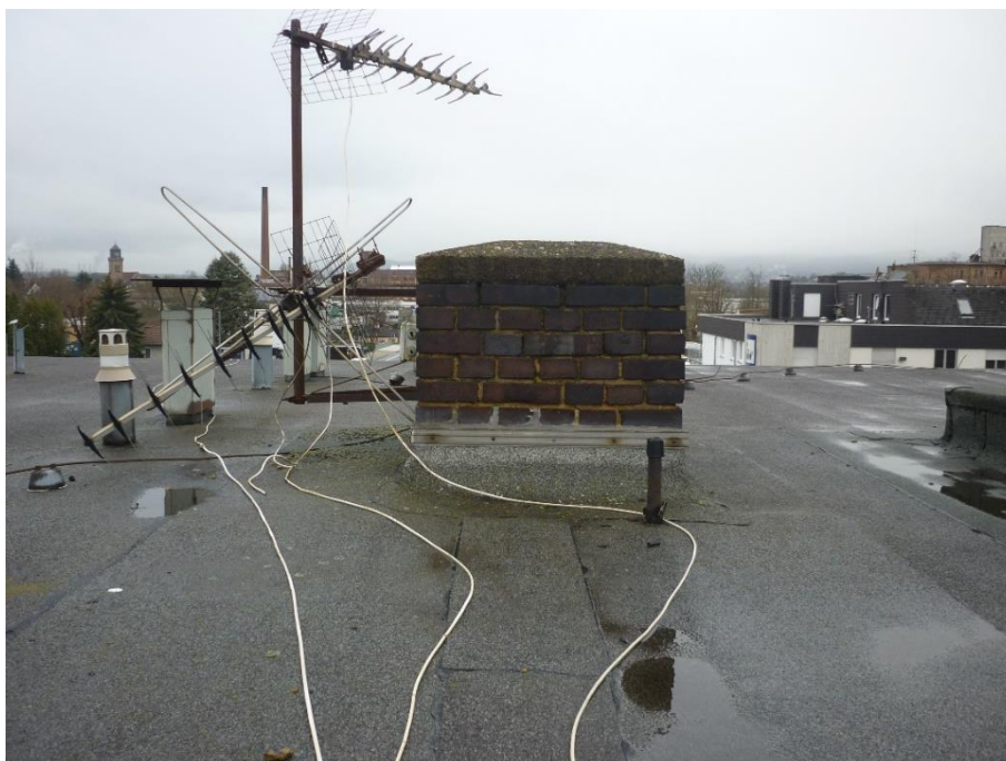
Abbildung 7: Blick auf den Schornstein von der Dachluke aus. Im Hintergrund sieht man die Belüftungsschächte.
