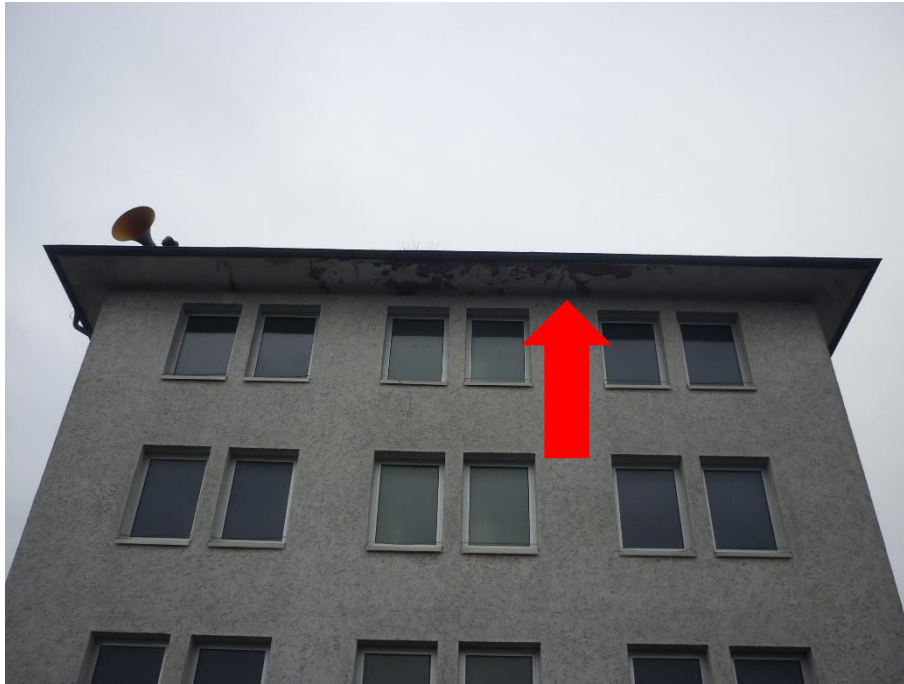
Abbildung 15: Blick auf die Fassade des alten Hotelgebäudes. Der rote Pfeil zeigt auf den Spalt zwischen Flachdach und Isolierung, der sich rund um das Gebäude zieht.
