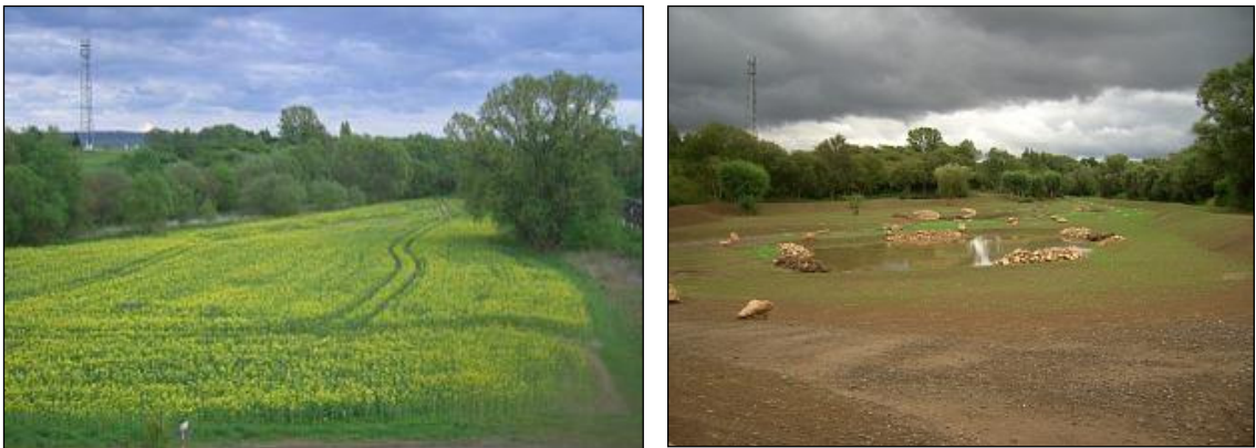
links: Standort des Rückhaltebeckens am Eselsgraben westlich des Keilsbergs (Blick nach Südosten) vor Baubeginn rechts: fertig gestelltes Rückhaltebecken (August 2011)
