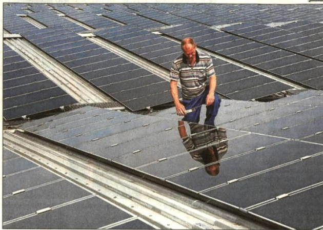
Kraftwerk auf dem Dach: Als ein Beitrag zum Klimaschutz sollen künftig mehr Solardächer an Kasseler Dächern installiert werden.
