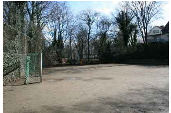
Oberflächenbelag mit Erneuerungsbedarf
